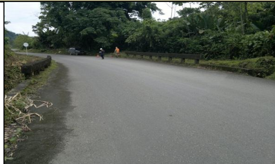
FOTO 2: PLACA IDENTIFICACIÓN PUENTE (NO EXISTE)
