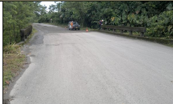
FOTO 2: PLACA IDENTIFICACIÓN PUENTE (NO EXISTE)
