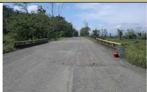
FOTO 2: PLACA IDENTIFICACIÓN PUENTE (NO EXISTE)
