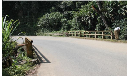
FOTO 2: PLACA IDENTIFICACIÓN PUENTE NO EXISTE
