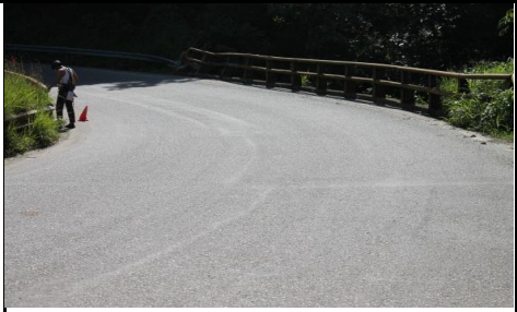
FOTO 2: PLACA IDENTIFICACIÓN PUENTE NO EXISTE
