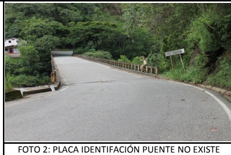
FOTO 2: PLACA IDENTIFICACIÓN PUENTE NO EXISTE
