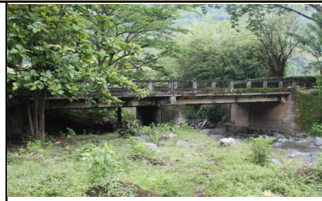
FOTO 2: PLACA IDENTIFICACIÓN (NO EXISTE)
