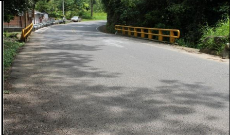
FOTO 2: NO EXISTE PLACA DE IDENTIFICACION
