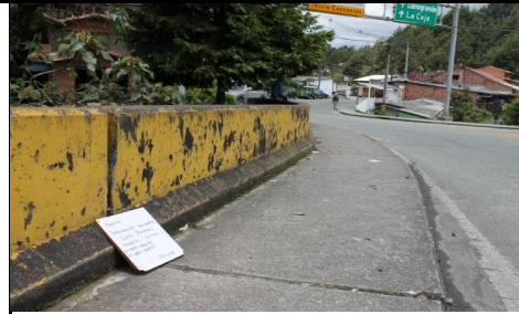
FOTO 2: PLACA IDENTIFICACIÓN PUENTE NO EXISTE
