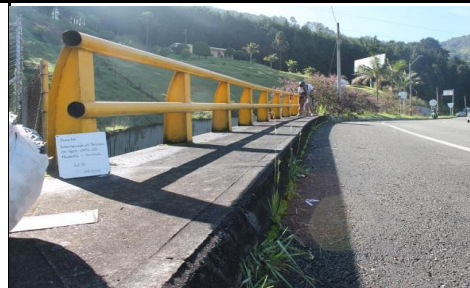
FOTO 2: PLACA IDENTIFICACIÓN PUENTE NO EXISTE
