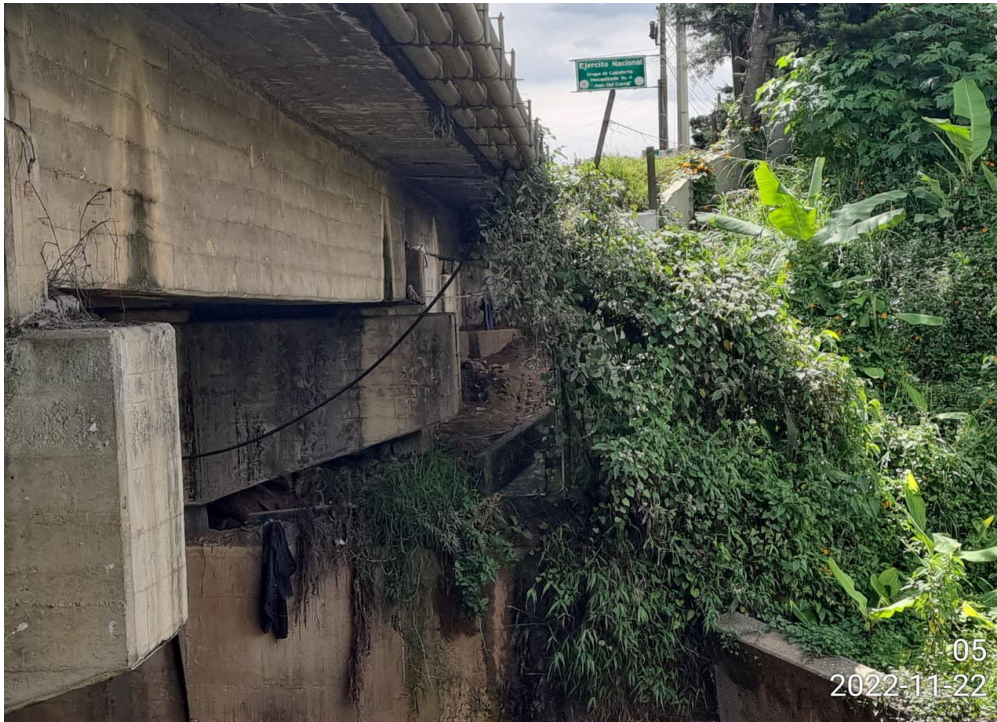
Conos y taludes:
